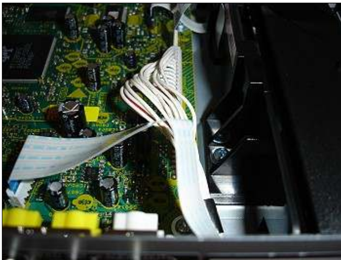
Wenige, recht sauber verlegte Kabelstränge
